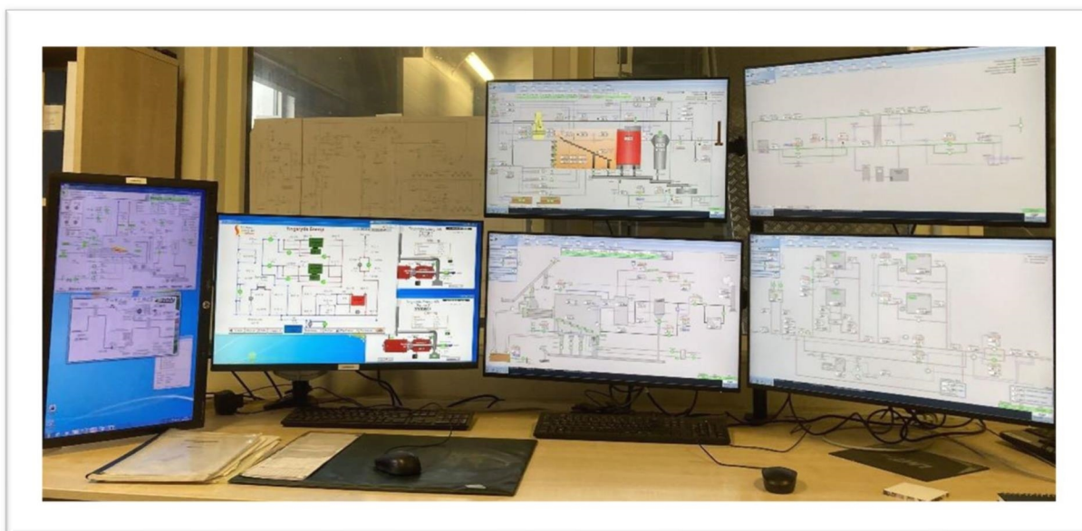
Övervakning av fjärrvärm nätet hos dotterbolaget Tingsryds Energi AB.
