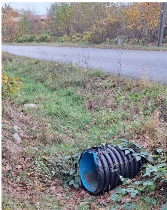
Vägtrumma för dagvatten under Transportvägen
