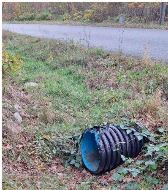
Vägtrumma för dagvatten under Transportvägen
